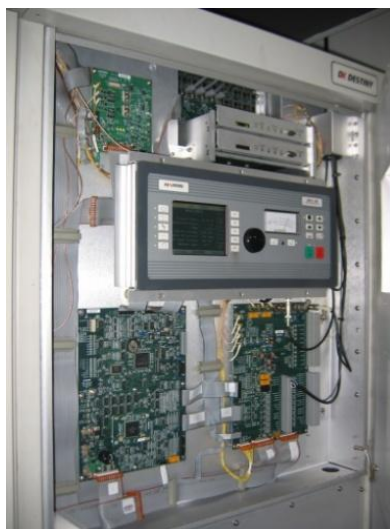
Figura 4 – Detalhe do transmissor Harris
